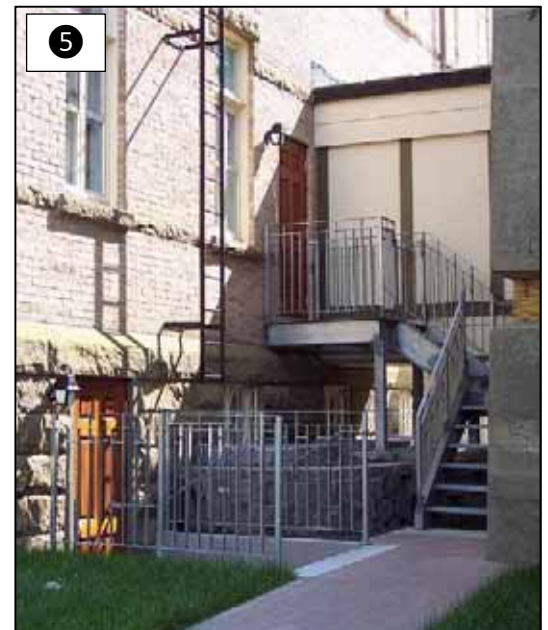
Travaux complétés pour les sorties de secours de la cafétéria, au sous-sol, ainsi que de l'escalier de l'est, au 1 er étage.
