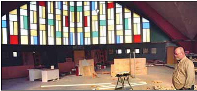
Les travaux de transformation de l'église Saint-Yves n'ont guère progressé depuis l'automne 2009. Photo : Ernie Wells, Le Progrès-Écho, 19 janvier 2011, p.5. Courtoisie
