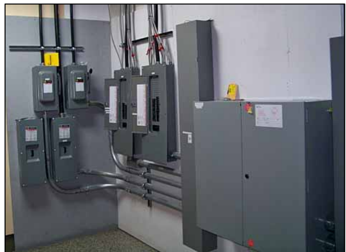
Nouvelle « salle des disjoncteurs » installée au sous-sol de l'aile nord-est dans un local attenant à la Pourvoirie d'autrefois et occupé jusqu'en 2019 par le photocopieur des Services diocésains. Photo : Yves-Marie Mélançon.
