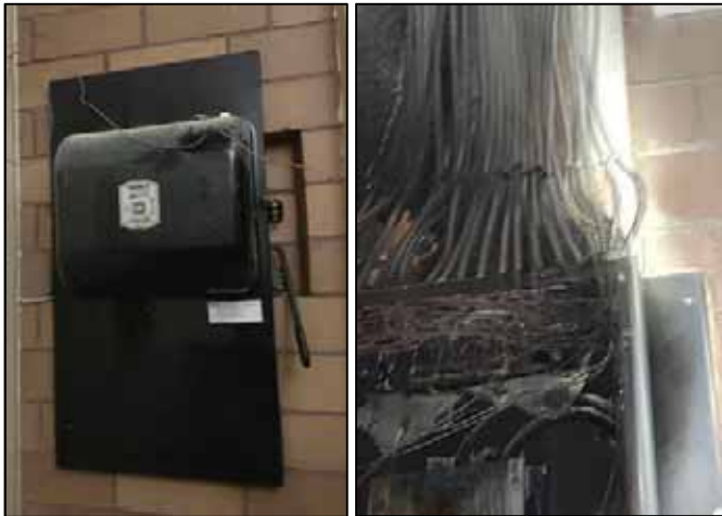
À droite et à l'origine de l'incendie, une boîte comme celle de gauche, mais encastrée dans le mur de la Pourvoirie d'autrefois. Photos : Bertrand Laplante.
