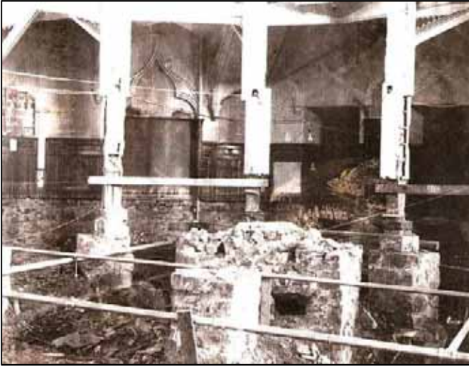
En 1967, le chœur de la cathédrale durant sa cure de rajeunissement. C'était après le démontage des planchers et avant le coulage d'une dalle de béton. Photo : Philippe Michaud, collection privée.
